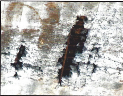
Bild 3: Betonschäden an der Unterseite der neuen Brücke; zu sehen von der Hauptstraße (Foto: Klais)
