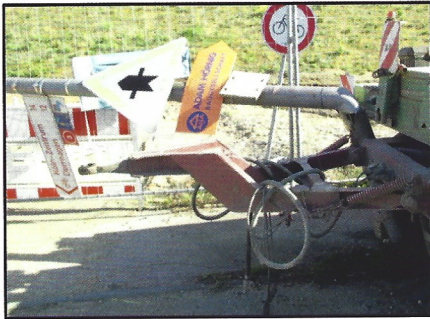
Bild 10: Bei Autobahnbauarbeiten umgeknickte Laterne (Foto: Klais)
